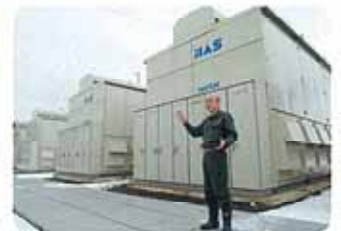
六ヶ所村二又風力発電所には2,000kWのNAS電池が17ユニット設置されています。
